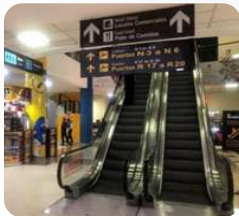
Ubicado en hall principal frente a puerta azul. Lado Este
